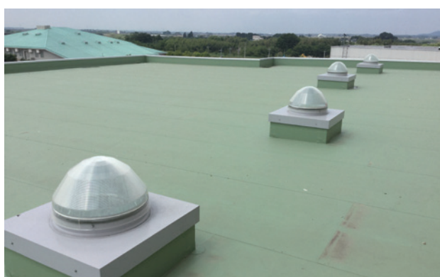
図7 光ダクト（採光部）
