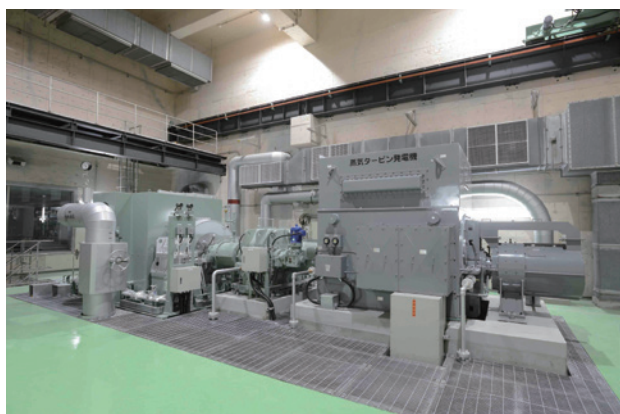
図5 更新後蒸気タービン発電機
