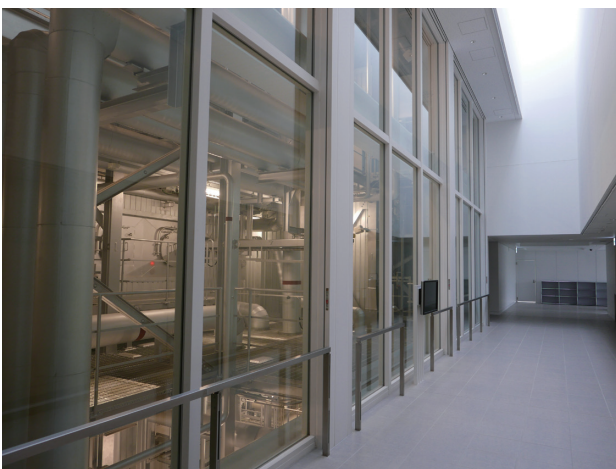
図8 焼却炉室見学者窓
